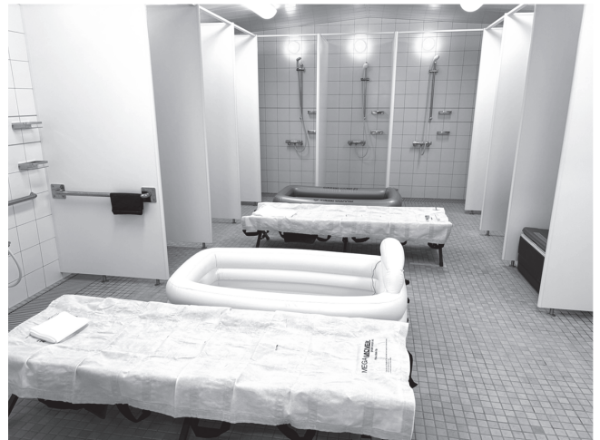
図5 国立競技場のHeat Deck
